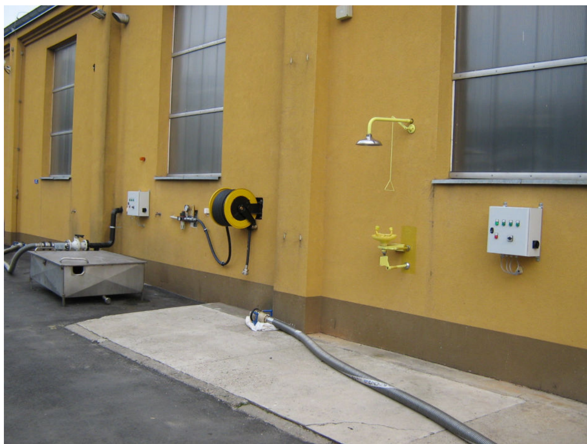
Zdjęcie 3. Control panels on unloading station.
