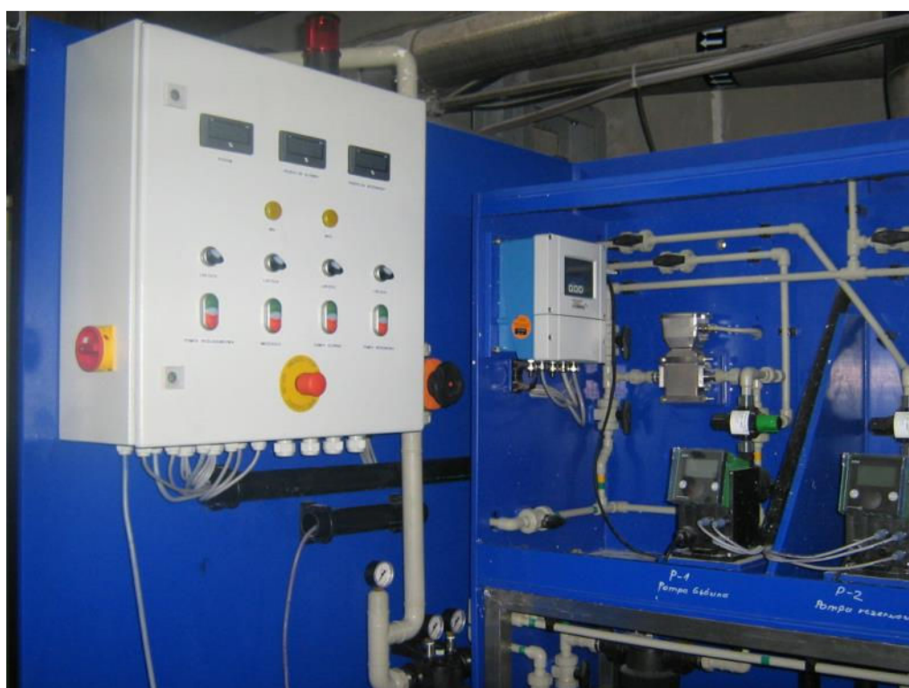
Zdjęcie 3. Zainstalowana szafa
