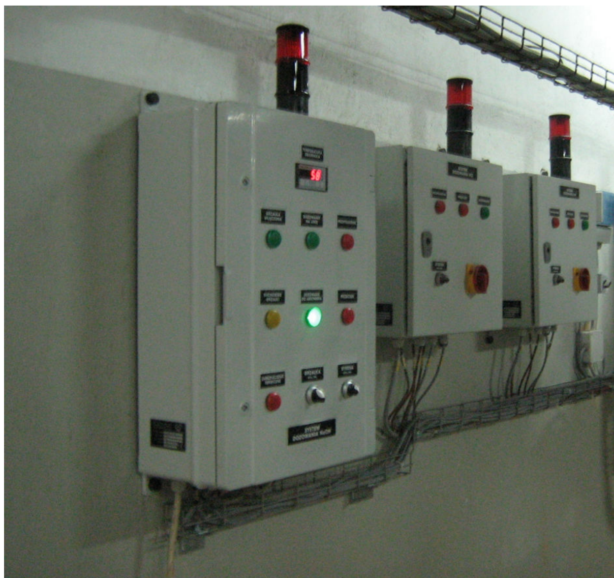
Zdjęcie 3. Zainstalowana szafa
