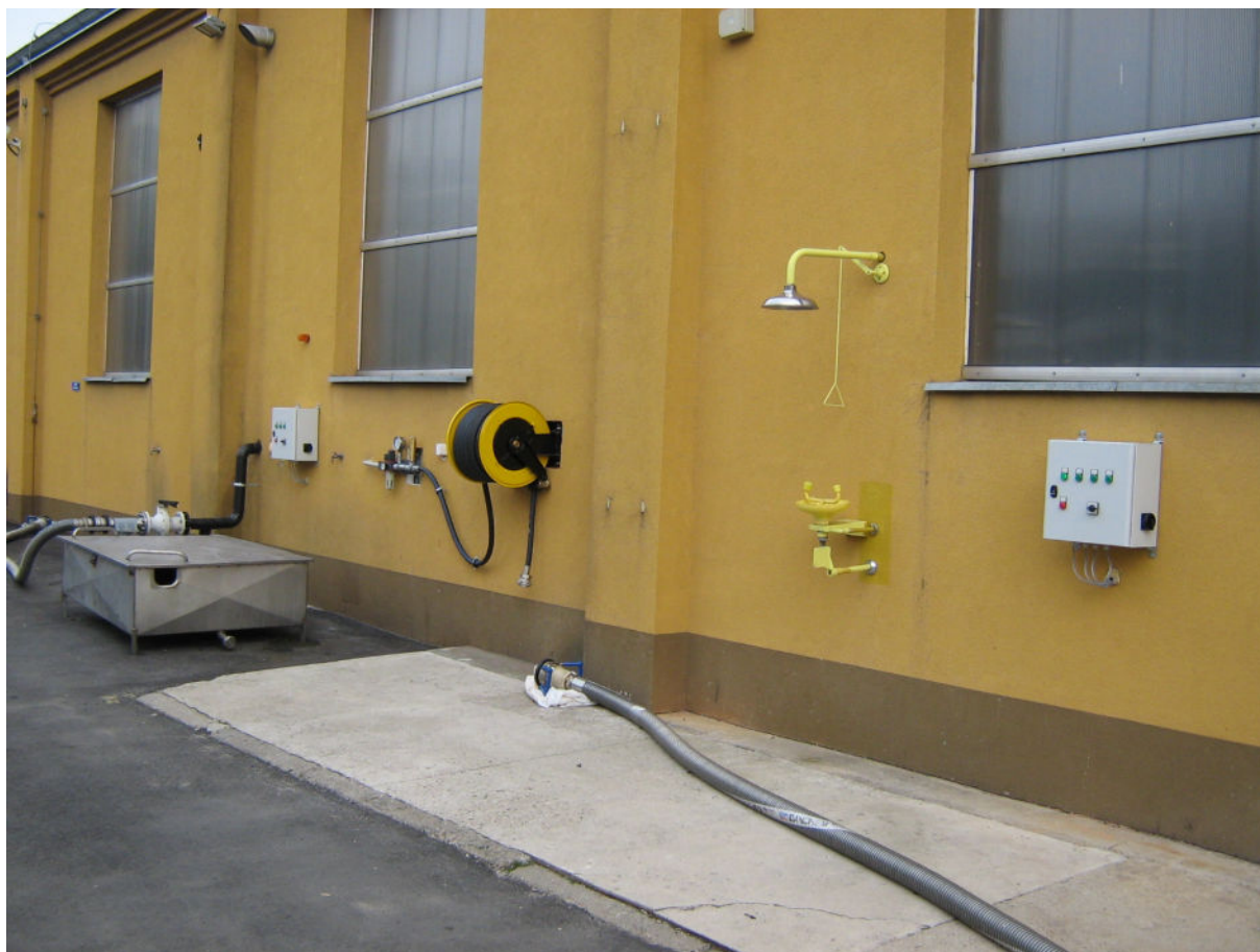
Zdjęcie 3. Widok szaf na stanowisku rozładunku.
