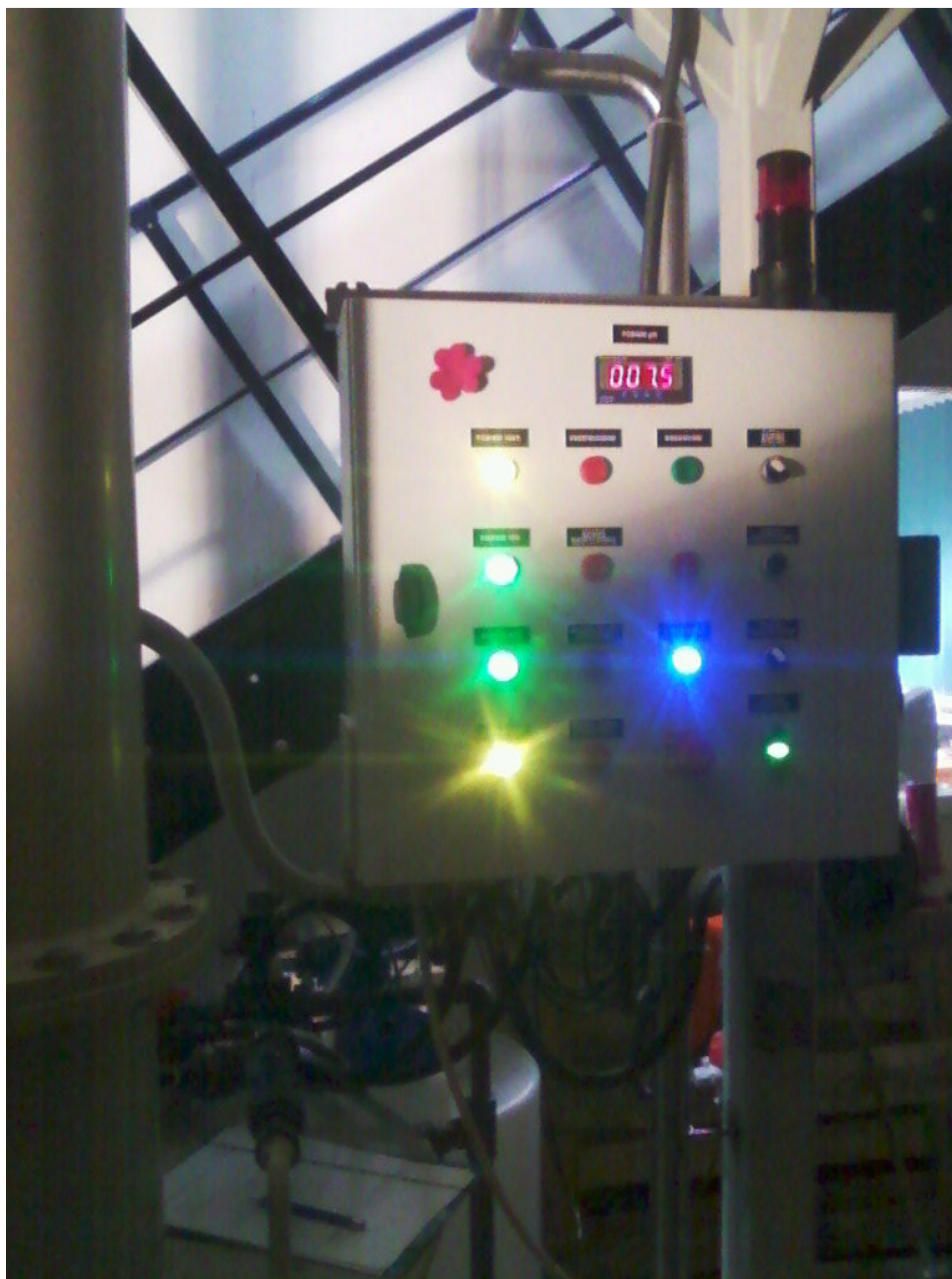
Zdjęcie 3. Zamontowana szafa.
