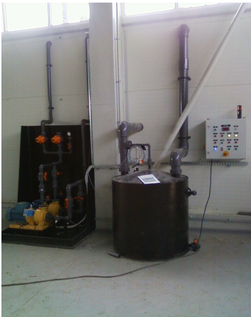
Zdjęcie 3. Miejsce instalacji
